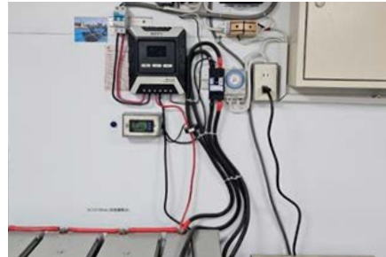
儲能設備組件
