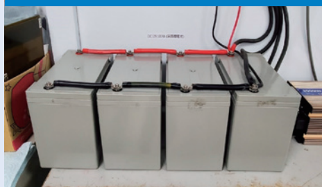
儲能設備組件
