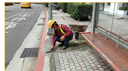
人行道破損修補
